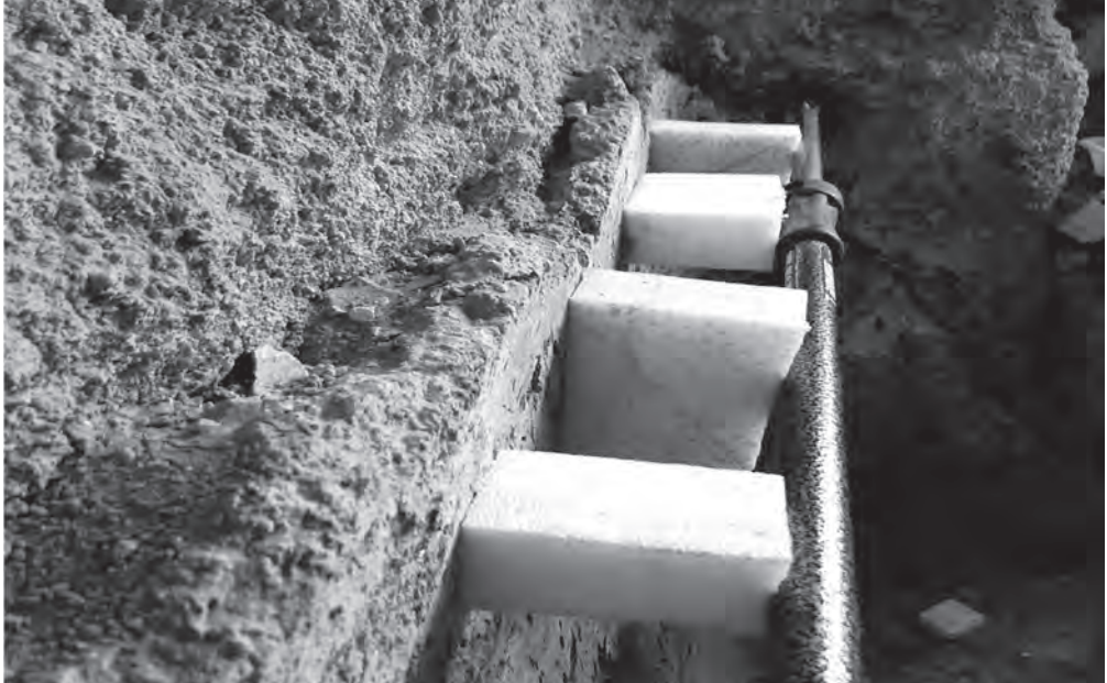
Figura 14. Acumulación de desechos entre el muro y la pintura.
